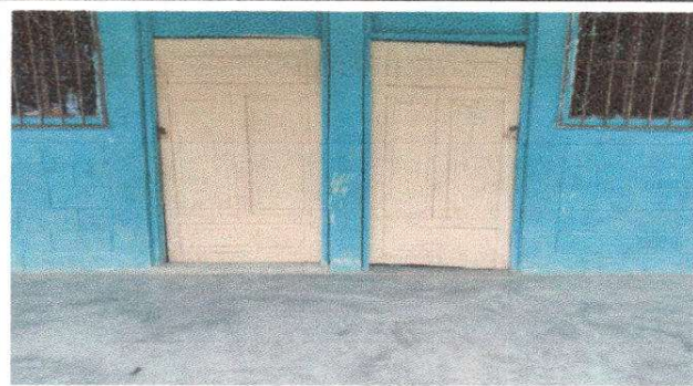
Foto 3: Puertas de las aulas
